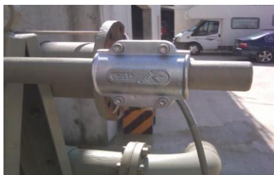
Tubería de 1 ½
